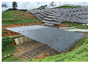
云县壹华镇“光伏+农业”项目
